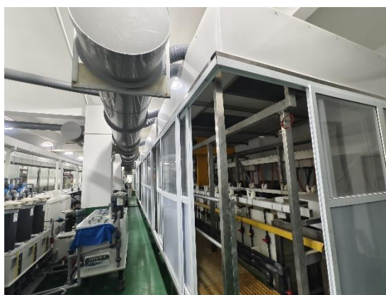
沉金线废气收集
