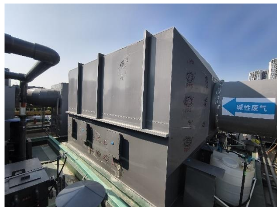
碱性废气处理设备
