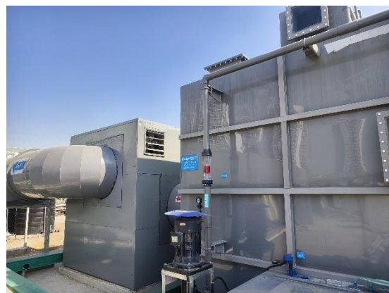
碱性废气处理设备
