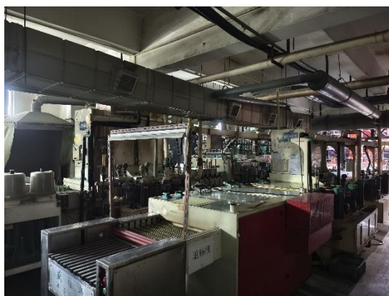
蚀刻线废气收集
