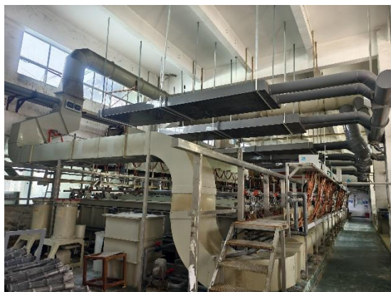
沉铜线废气收集
