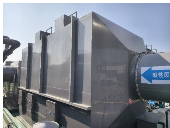
碱性废气处理设备
