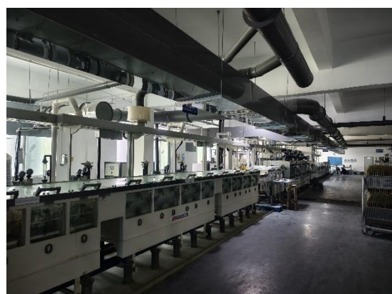
蚀刻线废气收集
